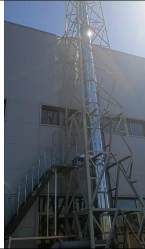
25m 高排气筒 (DA002)
