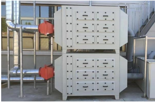
活性炭净化设施
